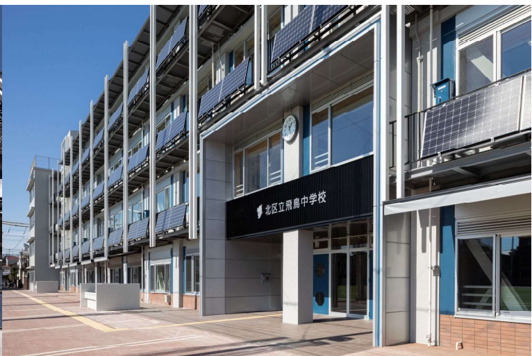
■エコウォール グラウンドに面して配列した庇機能のある太陽光パネルとエコウォール(設備架台)により、校舎の外観デザインを大きく一新しました。
