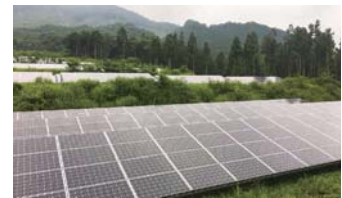
中之条町のメガソーラー発電所
