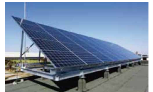
赤羽岩淵中学校の太陽光発電パネル
