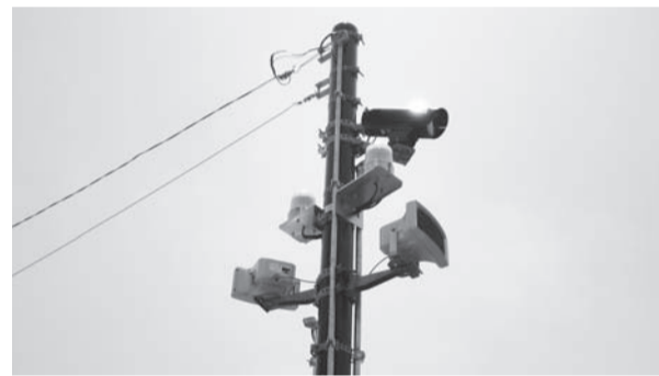
石神井川に設置されたカメラ
