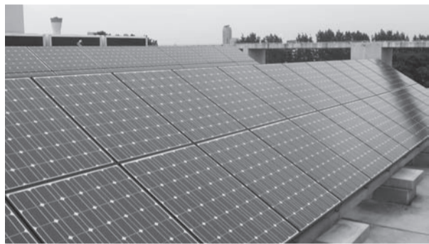
桐ヶ丘中学校太陽光パネル
