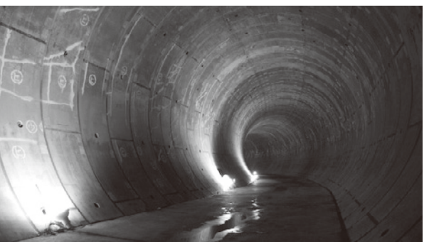
環状7号線地下調節池
