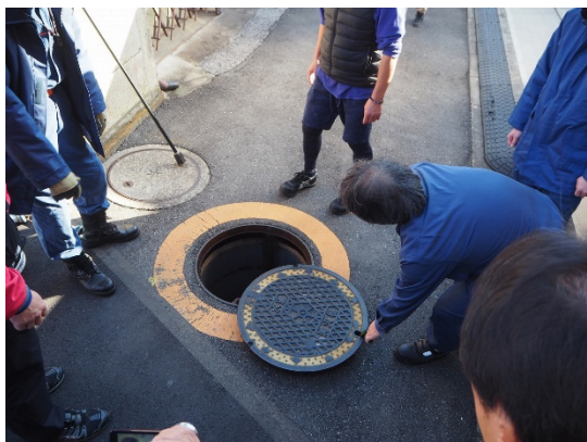
防災広場に接する道路上にある 消火栓の鉄蓋を開ける
