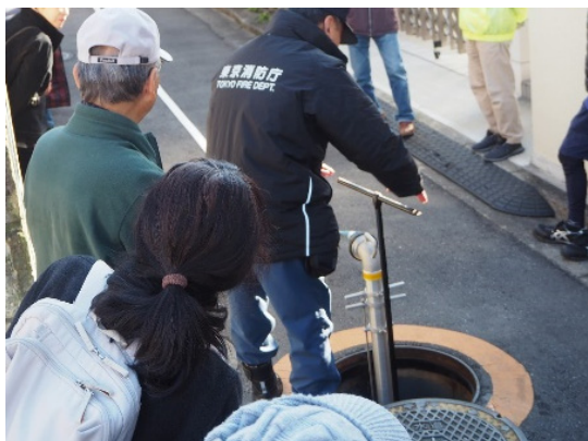
スピンドルドライバーをまわし 放水弁を緩める
