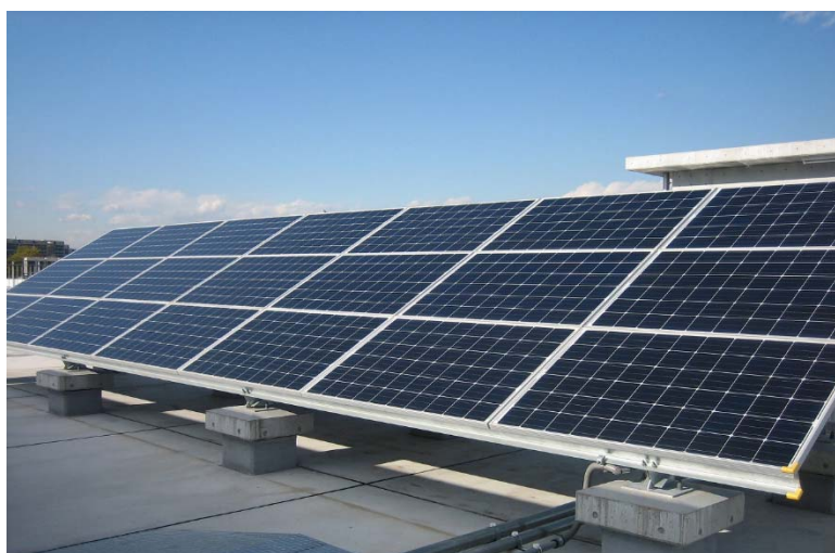
太陽光発電（中学校屋上設置）
