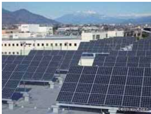
TDK（株）甲府工場の屋上の太陽光発電パネル
