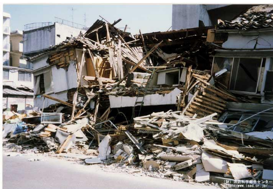
写真：倒壊した木造住宅（阪神・淡路大震災）
