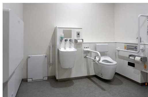
車椅子でも利用しやすいトイレ（開成町役場）
