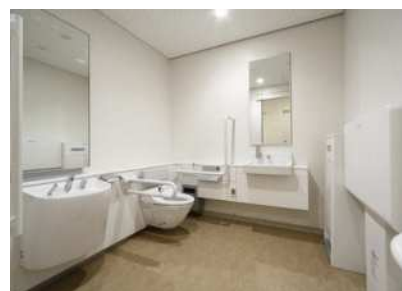
車椅子でも利用しやすいトイレ (さいたま市某施設)
