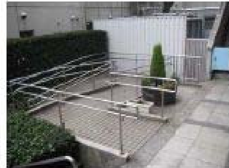
①スロープ(屋外) ・勾配が条例基準よりきつい。 ・床面が前後の通路との識別がしづらい。
