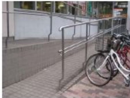
①スロープ(屋外) ・勾配が条例基準よりきつい。 ・床面が前後の通路との識別がしづらい。
