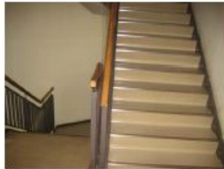
②階段 ・手すり位置が高く、端部が連続してないためつかみづらい。 ・端部が不適切な形状である。
