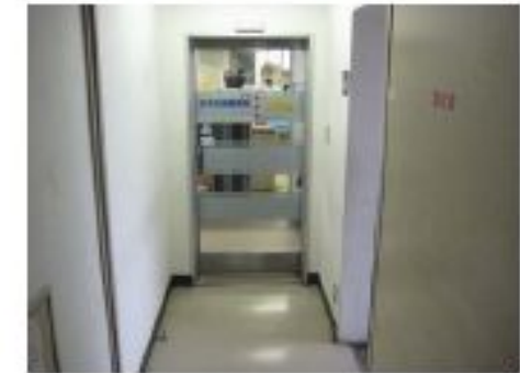
④廊下 ・幅員が条例基準より狭い。 ・出入口幅が条例基準より狭く、車いすやベビーカー等の通行がしづらい。
