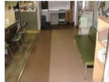
③保育課前の廊下 ・幅員が条例基準より狭い ・廊下が待合スペースとなっており、混雑時には通行に支障がある。 ・「赤ちゃん休憩室」が近くにない。
