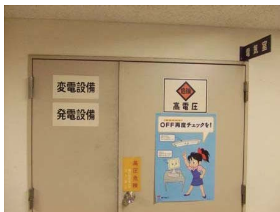
変電設備と発電設備が同一の電気室
