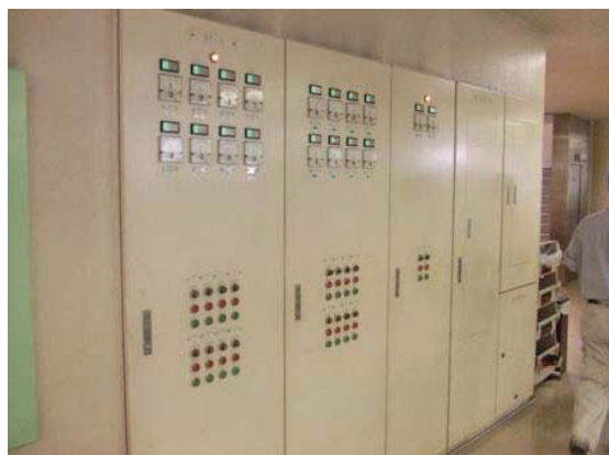
一般利用の廊下に設置された電気操作盤
