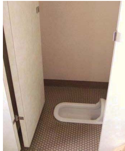
既存スペース不足による和式便器
