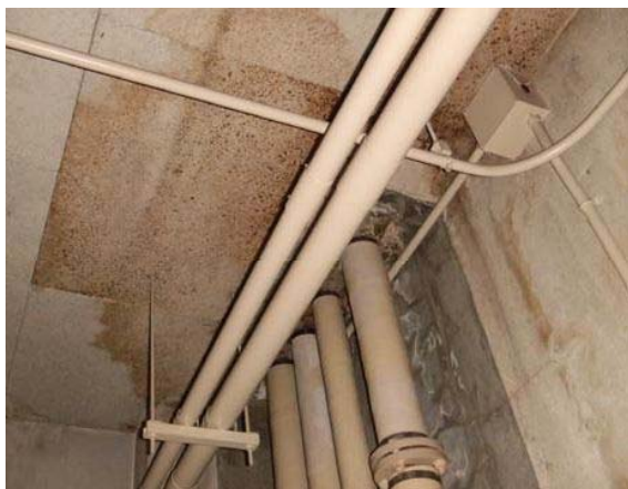
雨漏り跡がある天井
