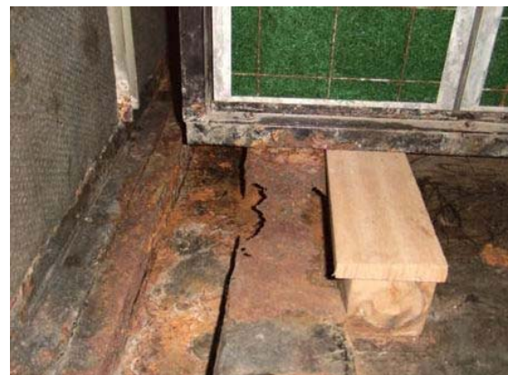
鉄部が腐食している設備類の受け板
