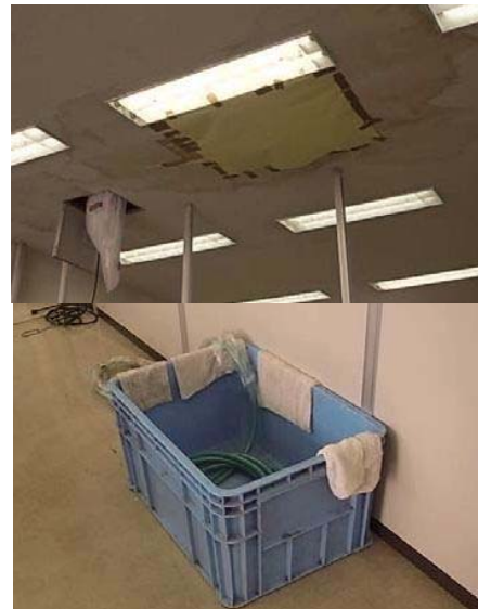
雨漏りの応急対策の状況
