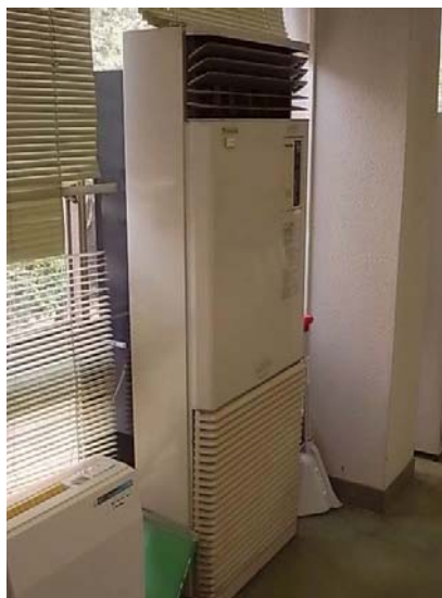
本体空調を補完する個別空調機
