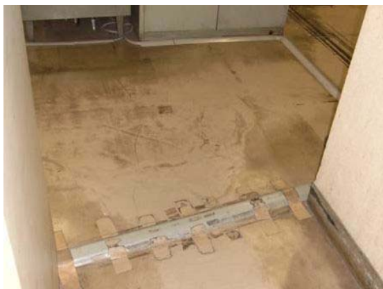
床面に露出設定している配線類
