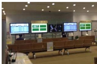
窓口呼び出しシステム（甲府市役所）
