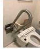
多目的トイレの稼働手すり
