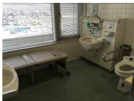
大型ベッドやオストメイト対応設備設置の例
